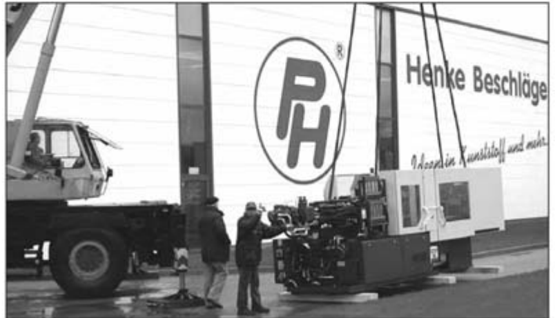
Seniorchef Dieter Henke (Bildmitte) begutachtet an der Brückenstraße das Abladen der 300. Spritzgießmaschine. Auf Kunststofftechnik setzt die Firma Henke Beschläge nun schon seit mehr als 45 Jahren.
